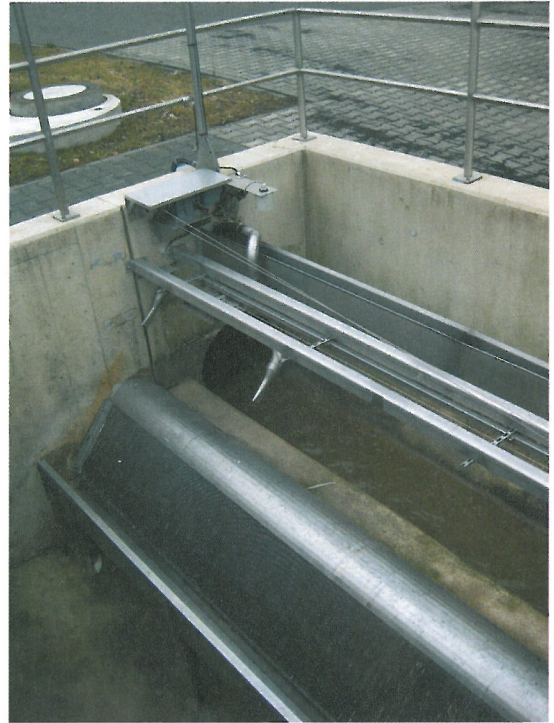
Abb. 1: Lamellenfeinsieb im Trennbauwerk
