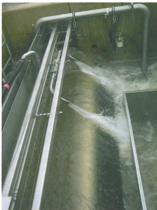
Abb. 2: Reinigung der Siebfläche während des Entlastungsereignisses
